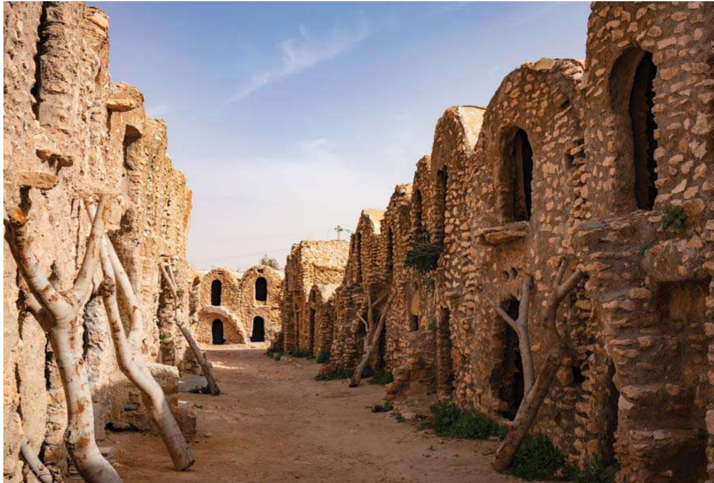
Ksar Hadada, pendant les travaux de restauration ©Skander Zarrad | Ksar Hadada during restoration work © Skander Zarrad | قصر حدادة أثناء أعمال الترميم © اسكندر زراد
